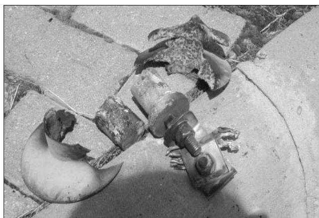
4. és 5. ábra Meghibásodott 20 kV-os túlfeszültség-levezetők
